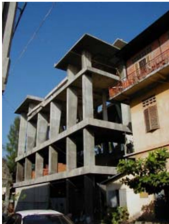
写真 - カンボジア国首都プノンペンに建設中の「ひろしまハウス」
